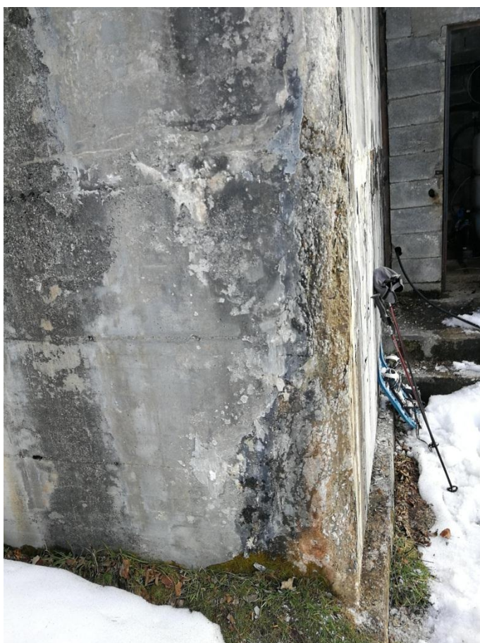
Imatges de l'estat del mur del dipòsit per l'exterior.
